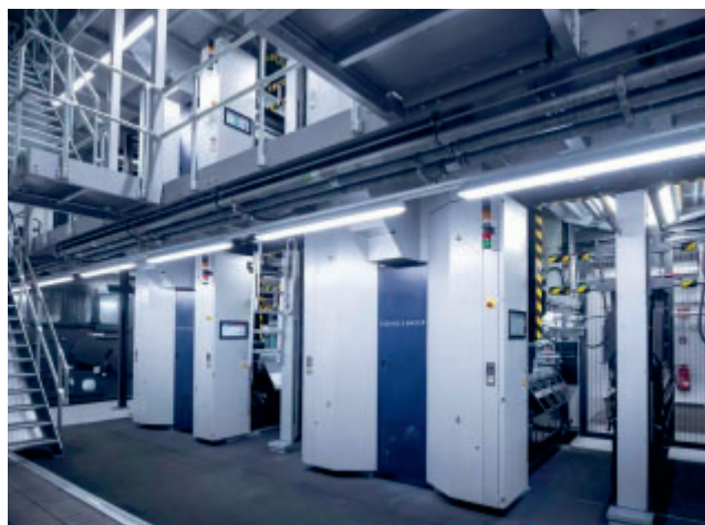
Obr. 4 – Novinová rotačka Koenig & Bauer Commander CL 4/2 je nově instalována v Mediengruppe Pressedruck.
